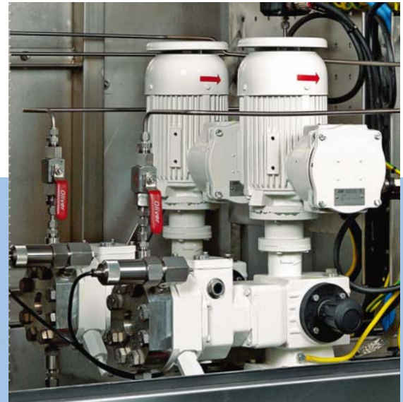
LEWA Dosierpumpen bilden die bewährte Basiskomponente für Odoranlagen
